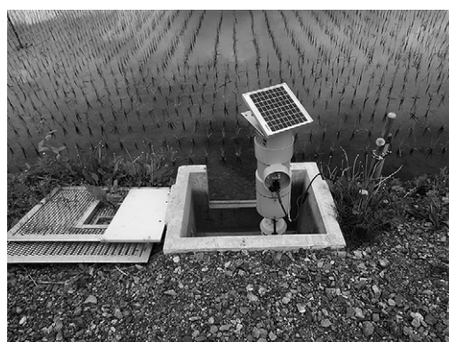
図6 水管理システム「ワタラス」
