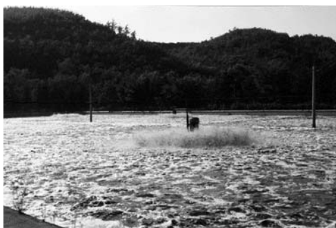
排水処理設備（小清水澱粉工場）
