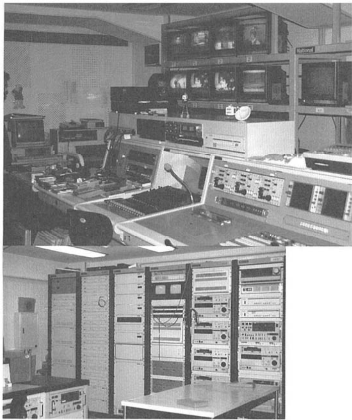
放送用機器がところ狭しと並んだ大山町CATV放送局の調整室
