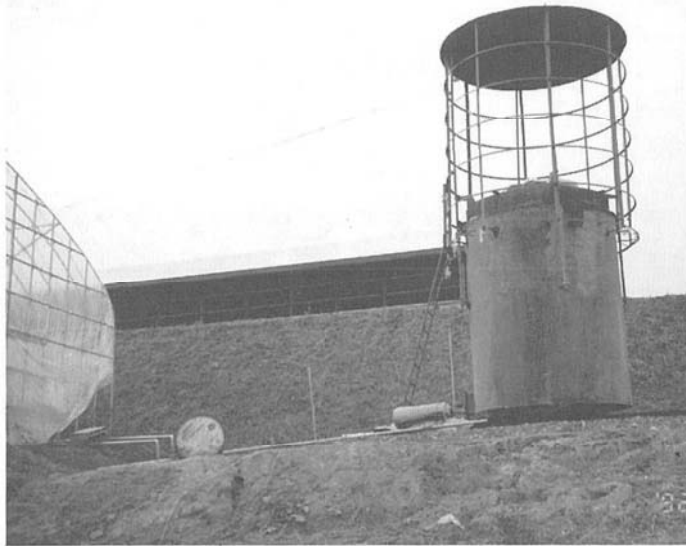
▼写真7 バイオガス貯溜タンク
