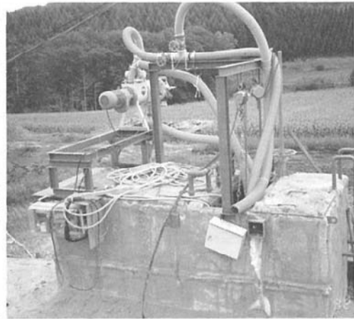
▲写真5 原料調整槽
